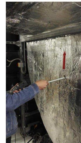
kontrola przepływu i spadku ciśnienia
